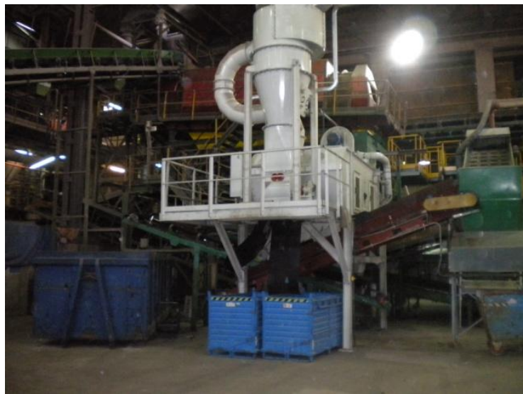
Foto 1 Dettaglio classificatore aeraulico esistente
