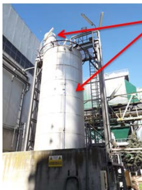
Coibentazione da rimuovere
