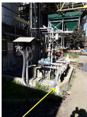
Vasca contenimento pompe
