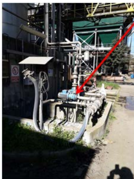
Pompe di carico da rimuovere
