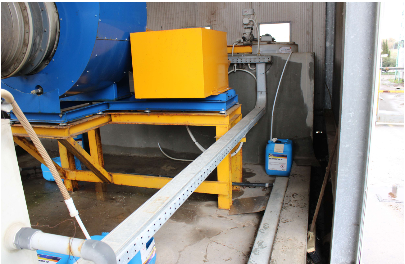
Area di stoccaggio D15 - Deodorizzante capannone maturazione compost
