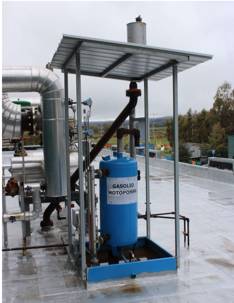
Serbatoio di gasolio C3
