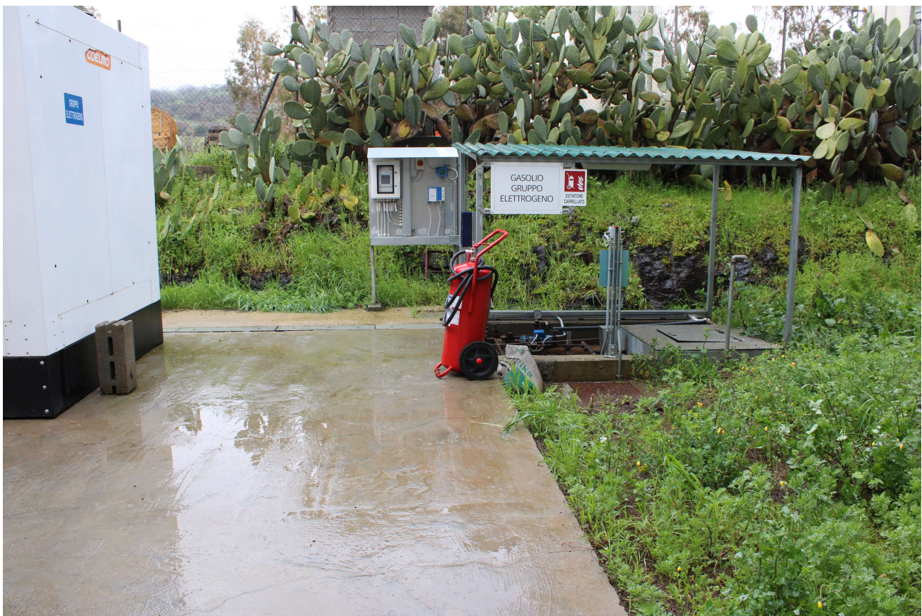
Serbatoio di gasolio C2: Punto di carico e gruppo di pompaggio
