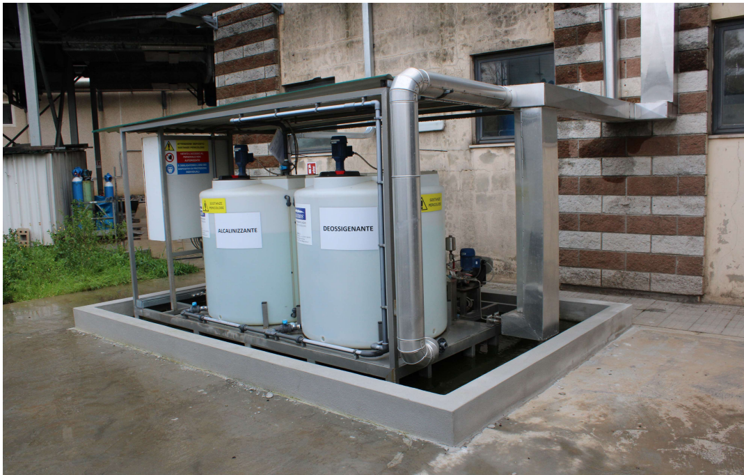
Serbatoi chemicals acqua caldaia D3 (deossigenante) e D4 (alcalinizzante)
