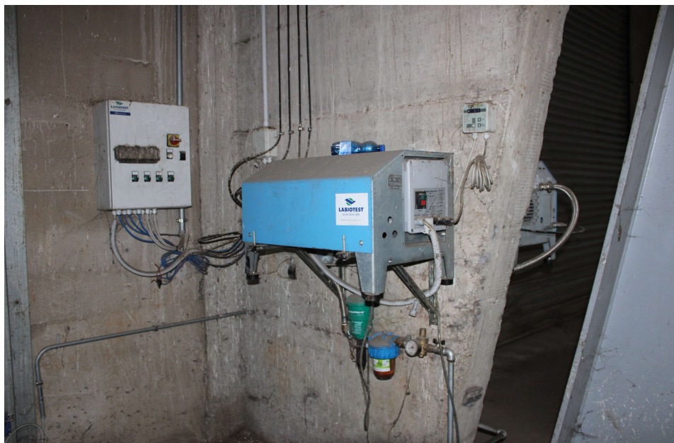
Area di stoccaggio D13 - Sistema dosaggio deodorizzante barriera osmogenica
