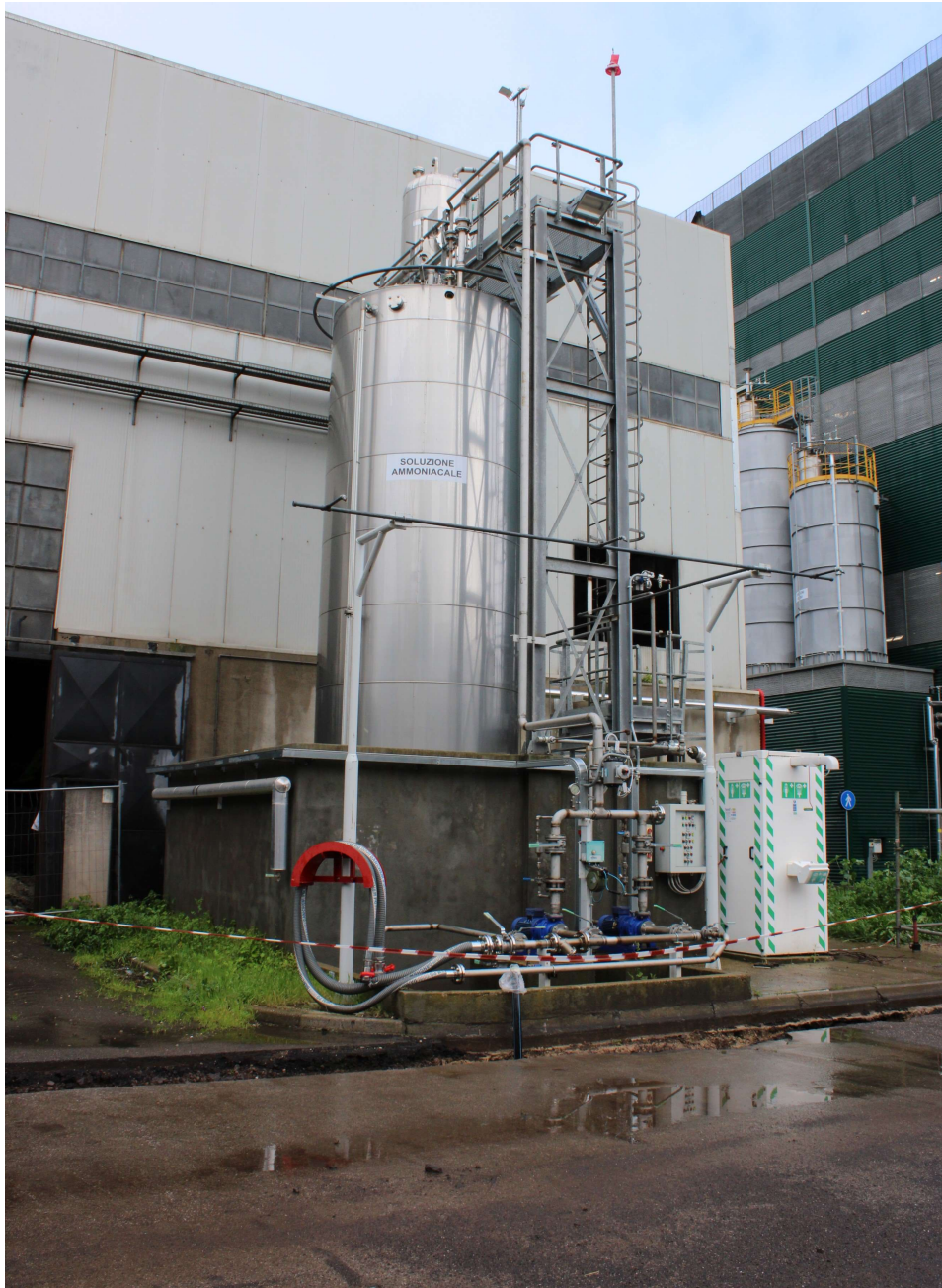
Serbatoio di stoccaggio soluzione ammoniacale D5
