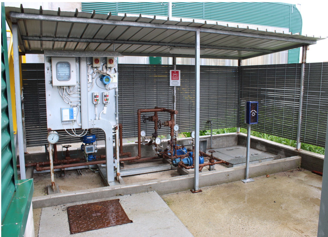
Serbatoio di gasolio C1: Punto di carico e gruppo di pompaggio
